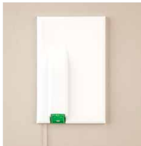
Fertige Installation der TAE
